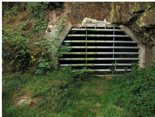
Figure 3 : Barreaux de protection d'un site à chauve-souris ©Bretagne Vivante.
